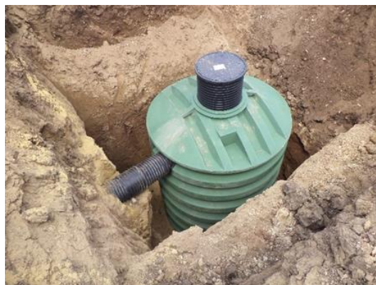
Obr. 6 – Nádrž usazená na svém místě
