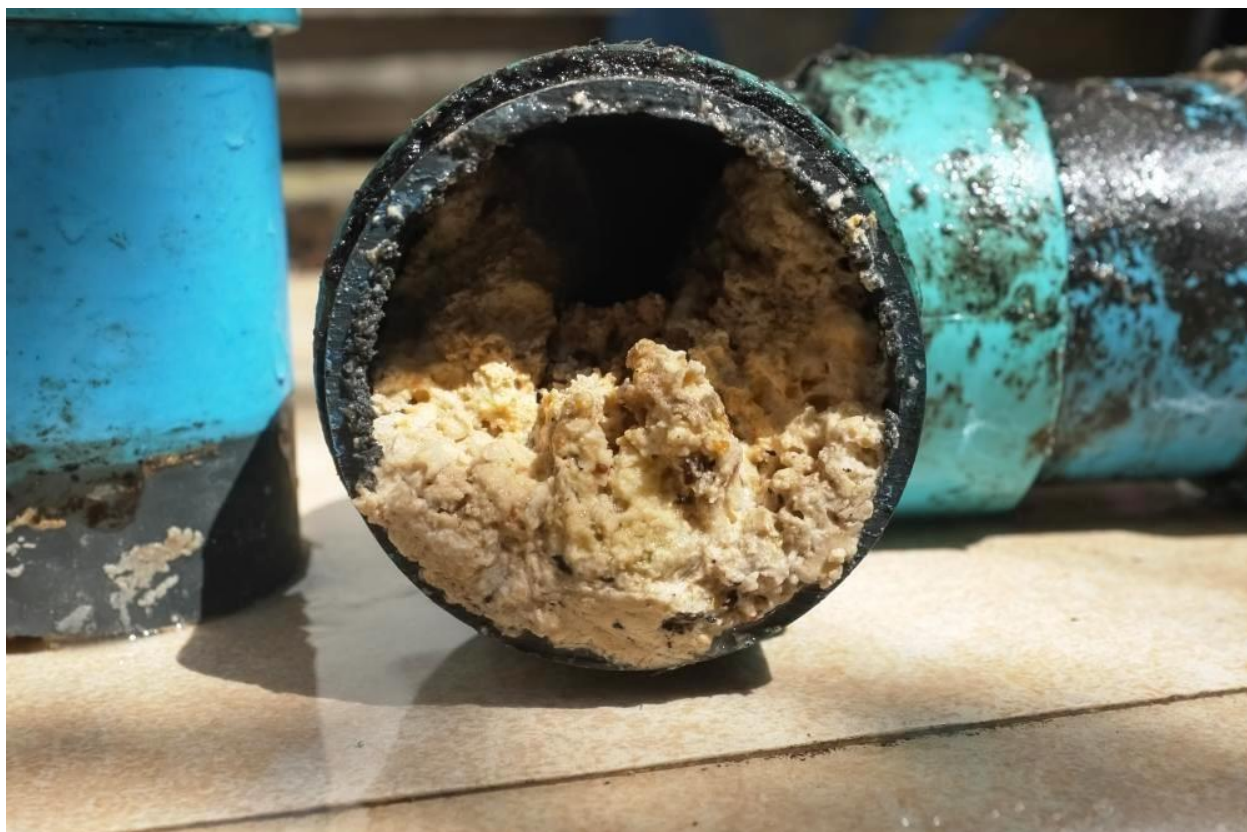
Obrázek 1: kanalizační potrubí ucpané tukem
